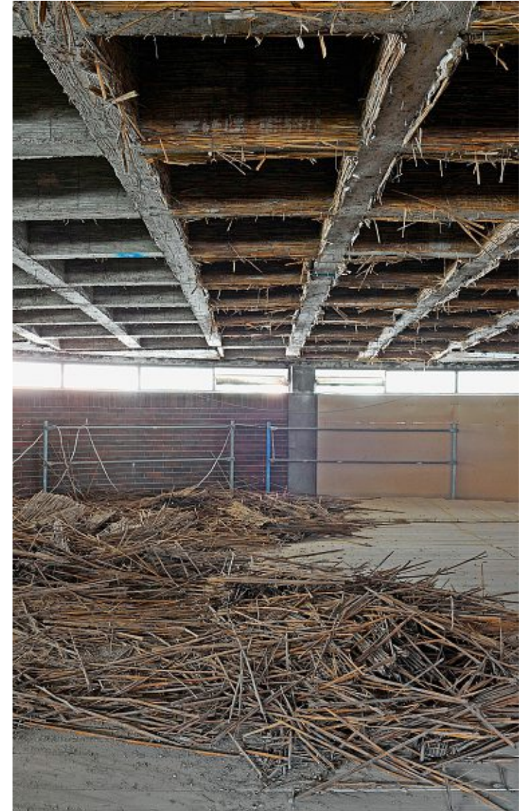
Die Schilfarmierungen waren eine der grossen Überraschungen, welche die Sanierung der Kirche St. Laurentius hervorgebracht hat.
